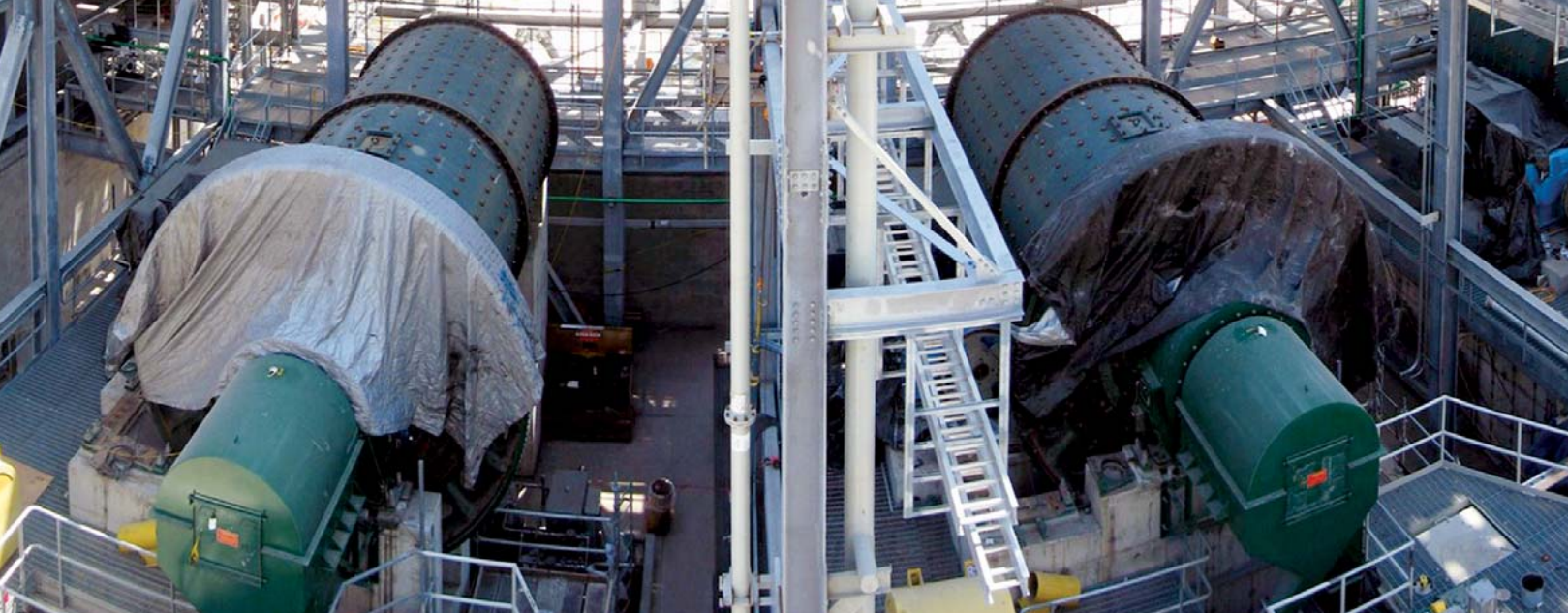
El sistema de preparación de piedra caliza tiene tres molinos cilíndricos (en la fotografía se ven el A y el B) en el sitio de Progress Energy Crystal River. Fotografía / Cortesía de Thomas Augustine
